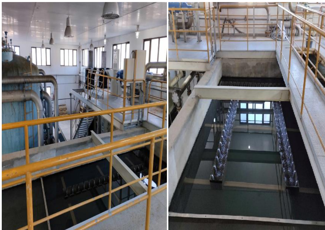
Слика бр. 11 и 12: Филтер станица - регионален водовод "Иловица"
