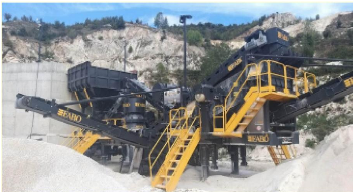
Слика 4. Секундарна постројка
