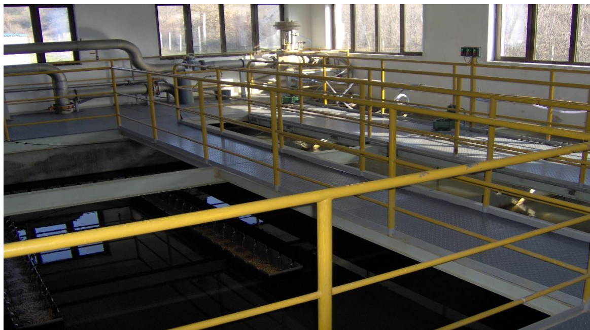
Слика бр. 9: Филтер станица - регионален водовод „Иловица“
